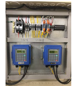
冰機流量計及數位電錶系統
